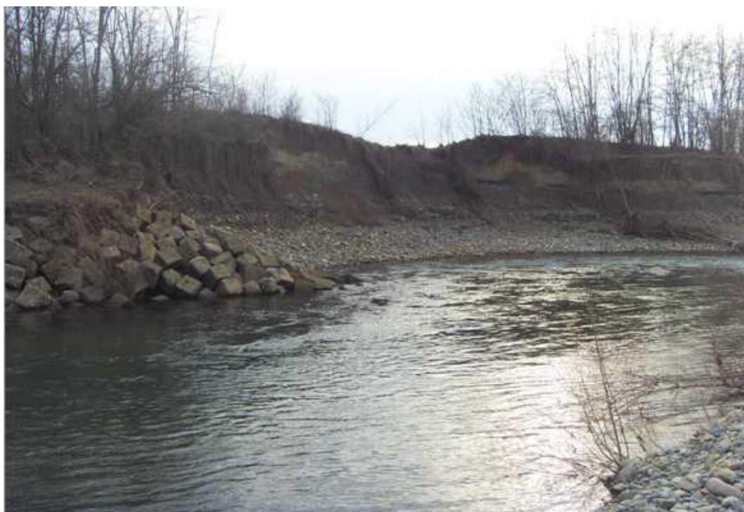
Fig. 3 Torrente Orba, sez. 12; particolare dell'asportazione della difesa di sponda e del collasso del paramento dell'argine retrostante ( area di intervento )
