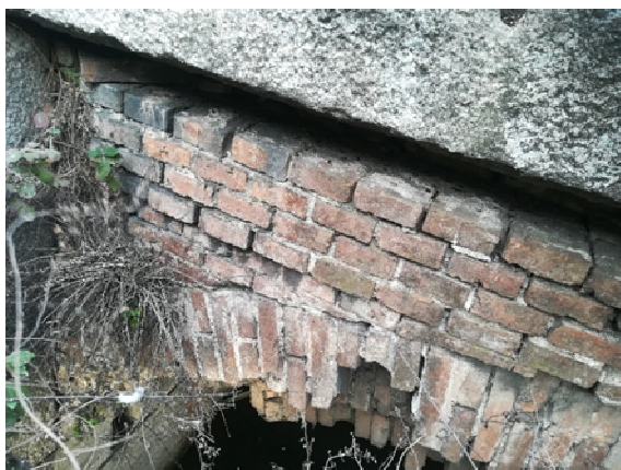
Ammanchi di muratura sui canali di scarico secondari
