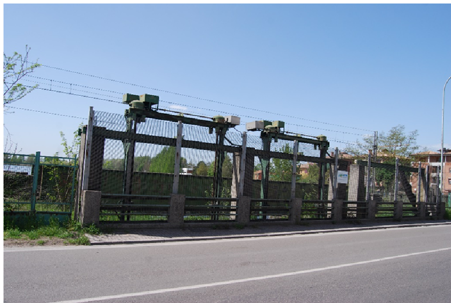
Recinzione in grigliato elettrosaldato di protezione dei castelli delle paratoie secondarie
