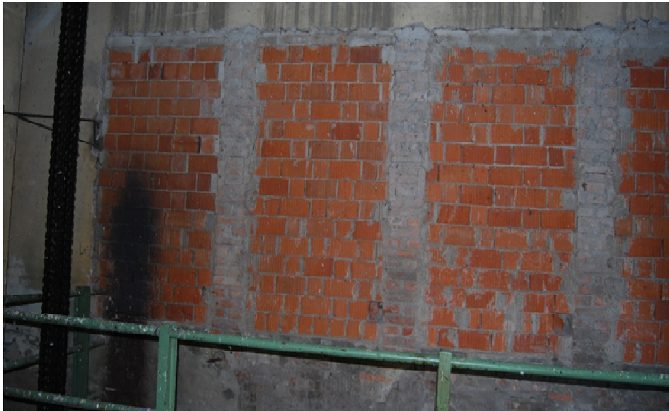
Tamponamento delle aperture originarie con elementi in laterizio semipieno
