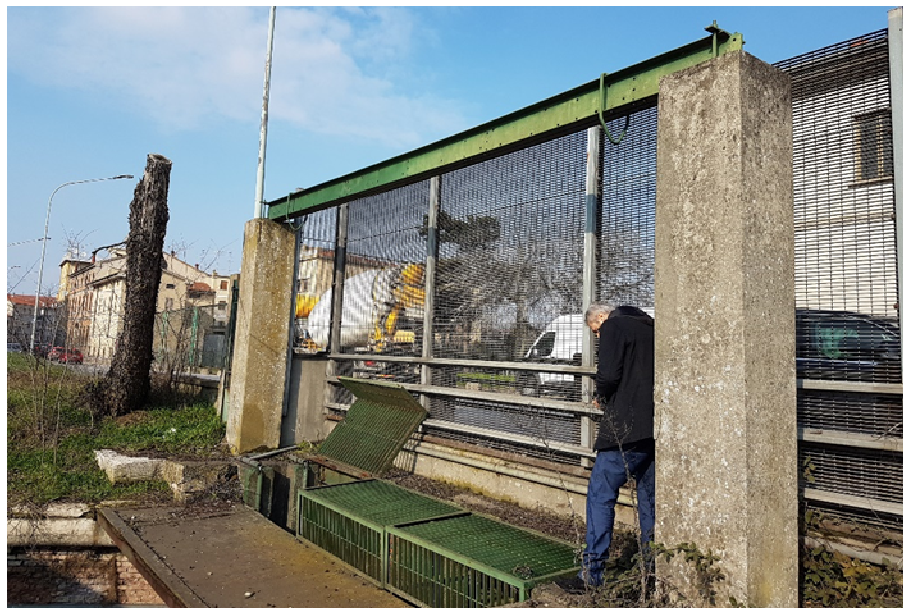
Protezione della feritoia di scorrimento dei panconi del canale principale
