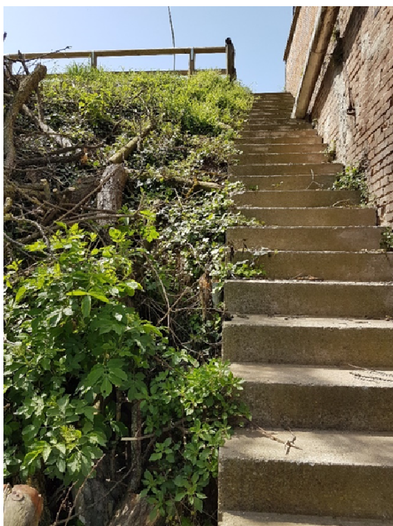
Parapetto in legno crollato
