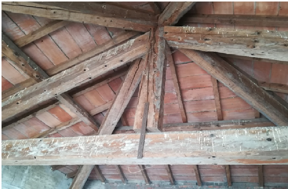
Solaio di copertura in legno e laterizio del locale di alloggiamento della paratoia principale
