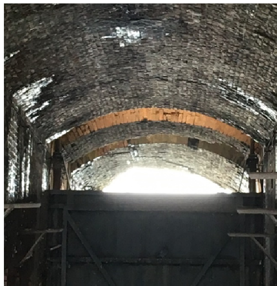
Ammanchi di muratura sui canali di scarico secondari
