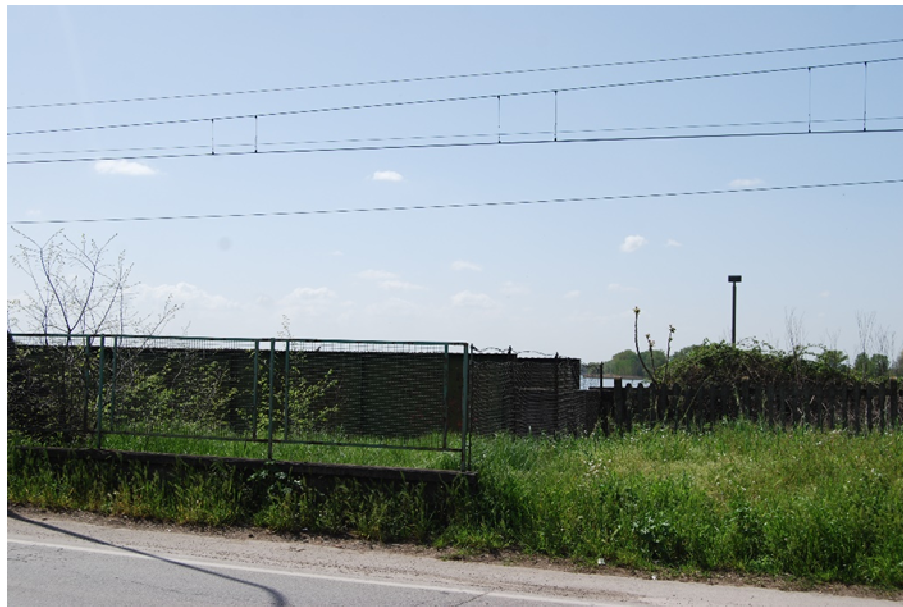
Recinzione in rete metallica in Sx idraulica
