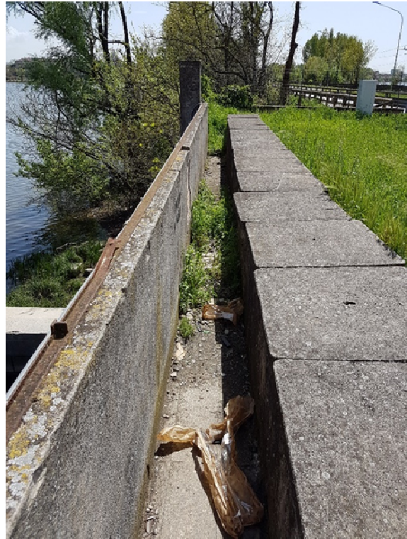
Cunicolo di alloggiamento della tubazione TEA S.p.a.
