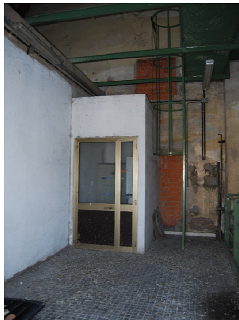
Locale quadri elettrici e di comando
