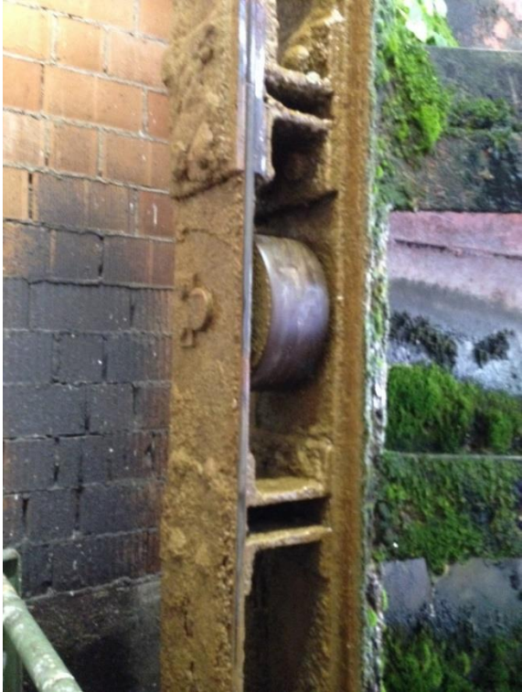
Usura dei profili costituenti la paratoia principale
