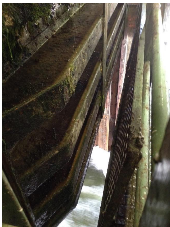
Struttura della paratoia principale
