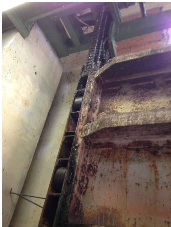
Ruote di scorrimento della paratoia principale
