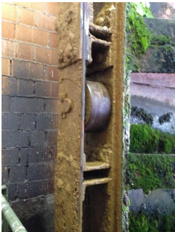
Usura dei profili costituenti la paratoia principale
