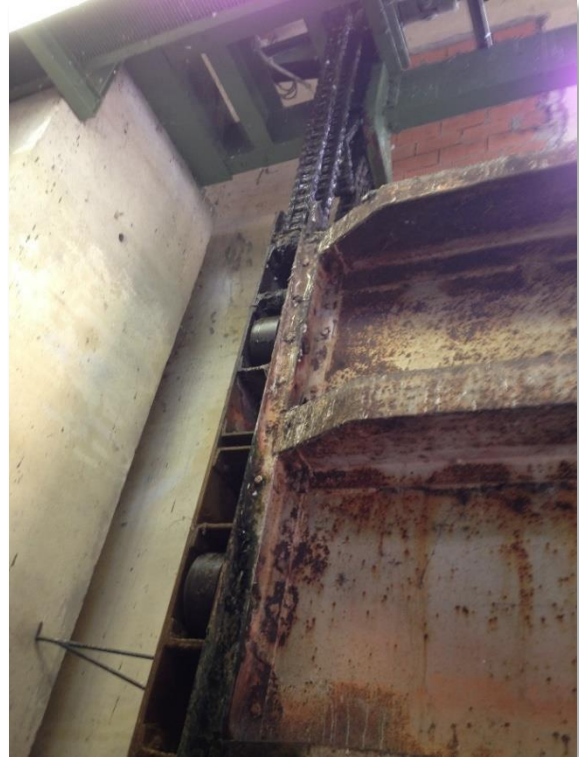
Ruote di scorrimento della paratoia principale
