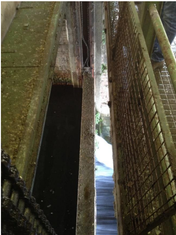
Gargamature della paratoia principale
