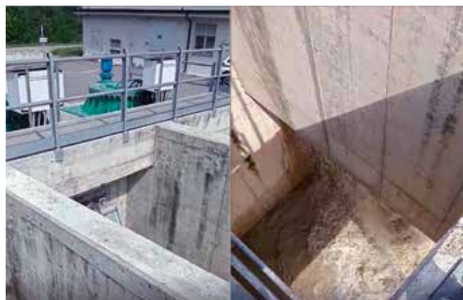
Impianto Idrovoro e chiavica Rio Loreto - attivazione di prova
