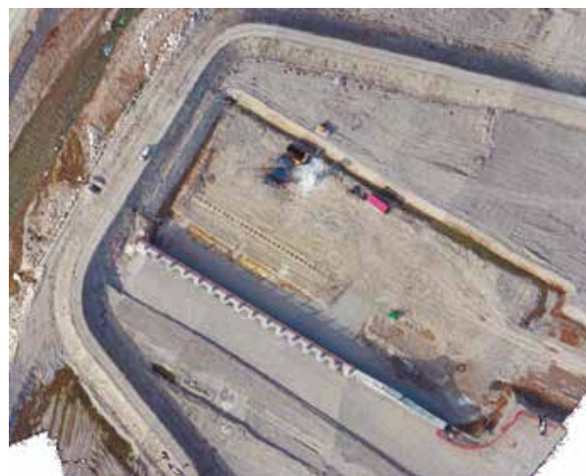
Figura 5 - Ortofoto rappresentativa dell'avanzamento dei lavori sulla Briglia di monte alla data del 21 marzo
