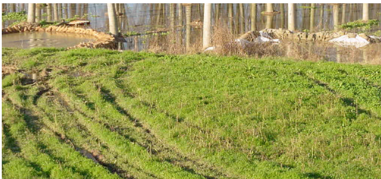
- Fig.5 Infiltrazione all'unghia a campagna – Foce Oglio
