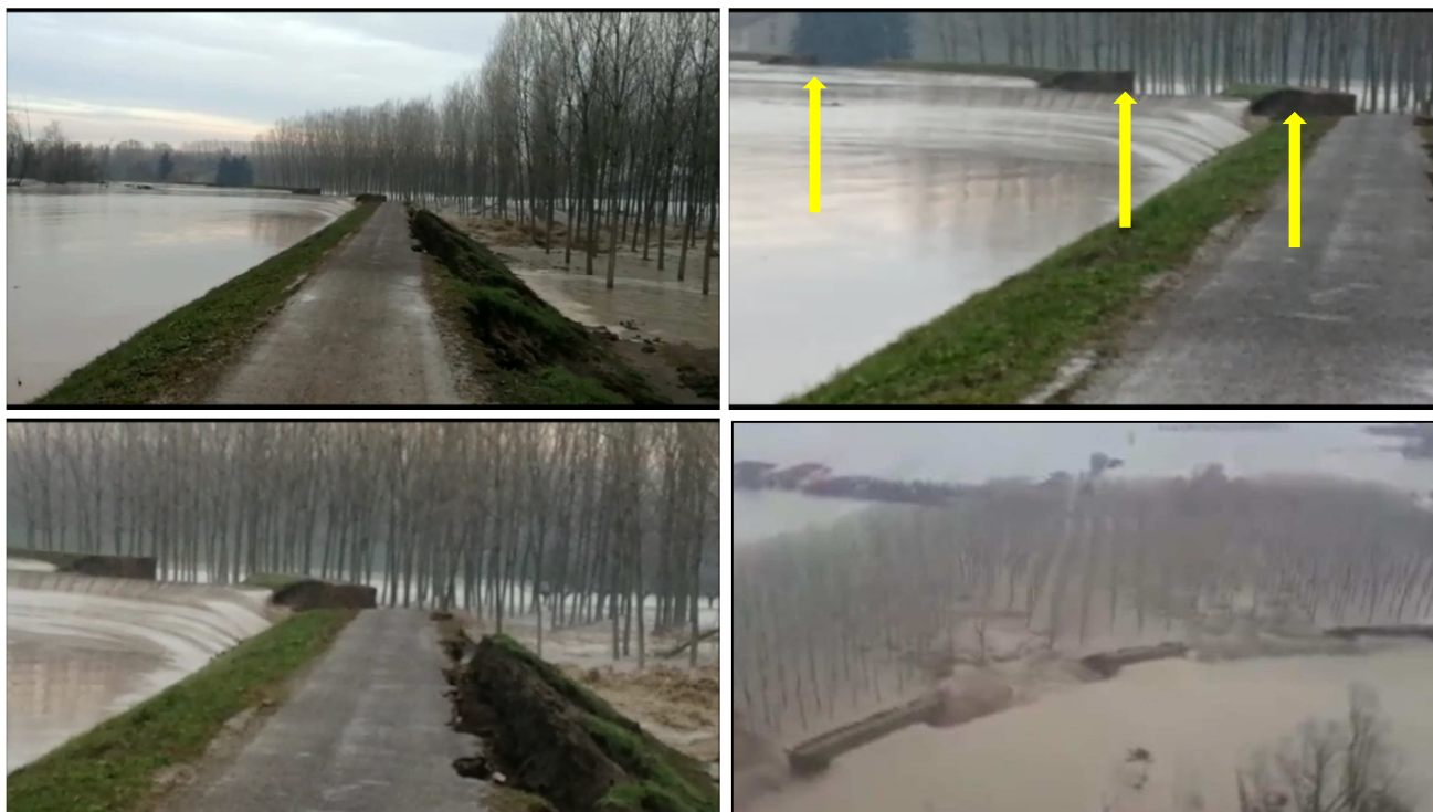
Figura 30. Rotta arginale verificatasi nell'argine destro del Torrente Enza all'altezza del centro abitato di Lentigione. Sono visibili le n. 3 brecce createsi nell'arginatura.
