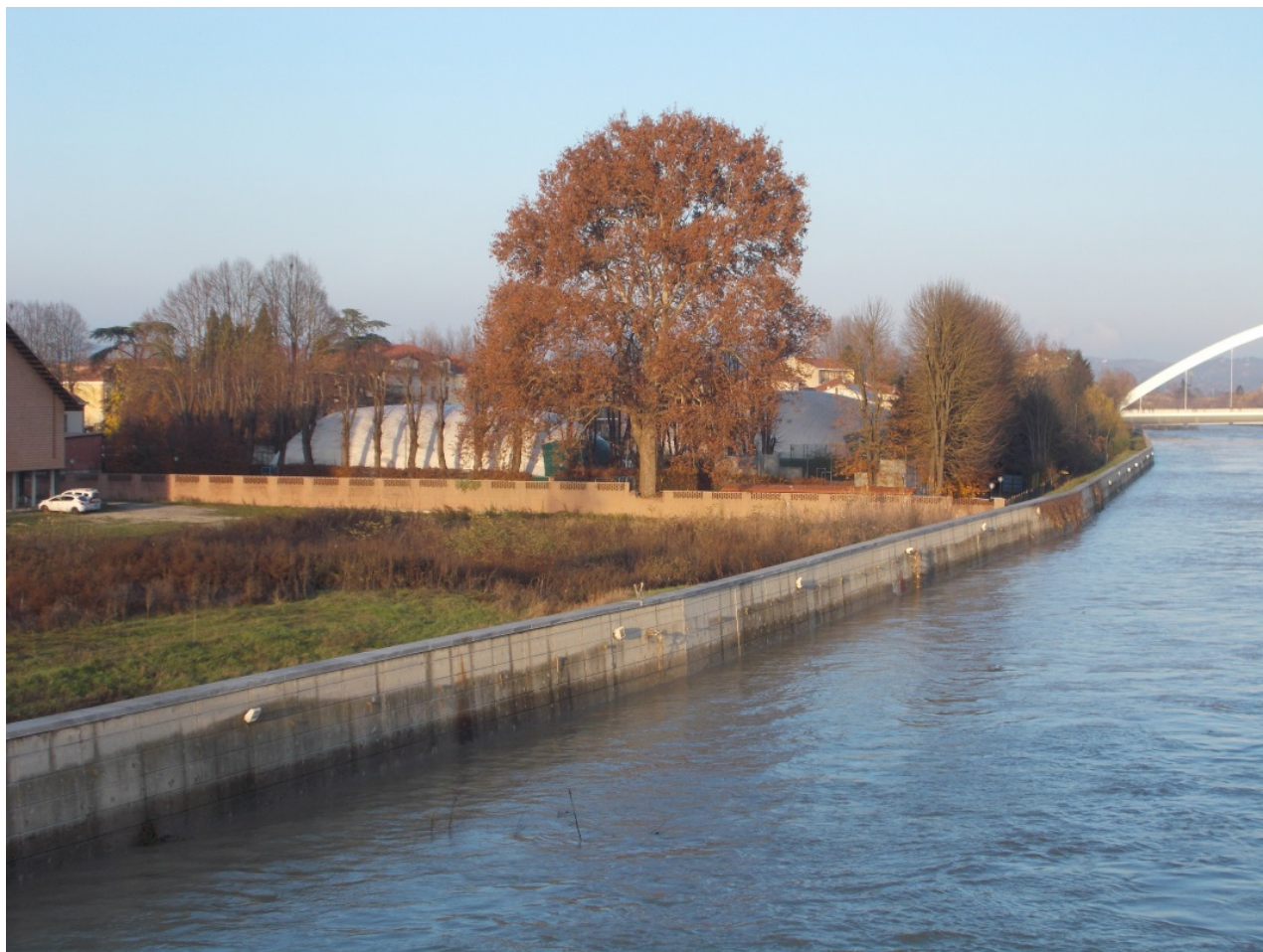
Il Tanaro ad Alessandria dopo il passaggio della piena; è evidente sul muro il segno del livello raggiunto dall'acqua
