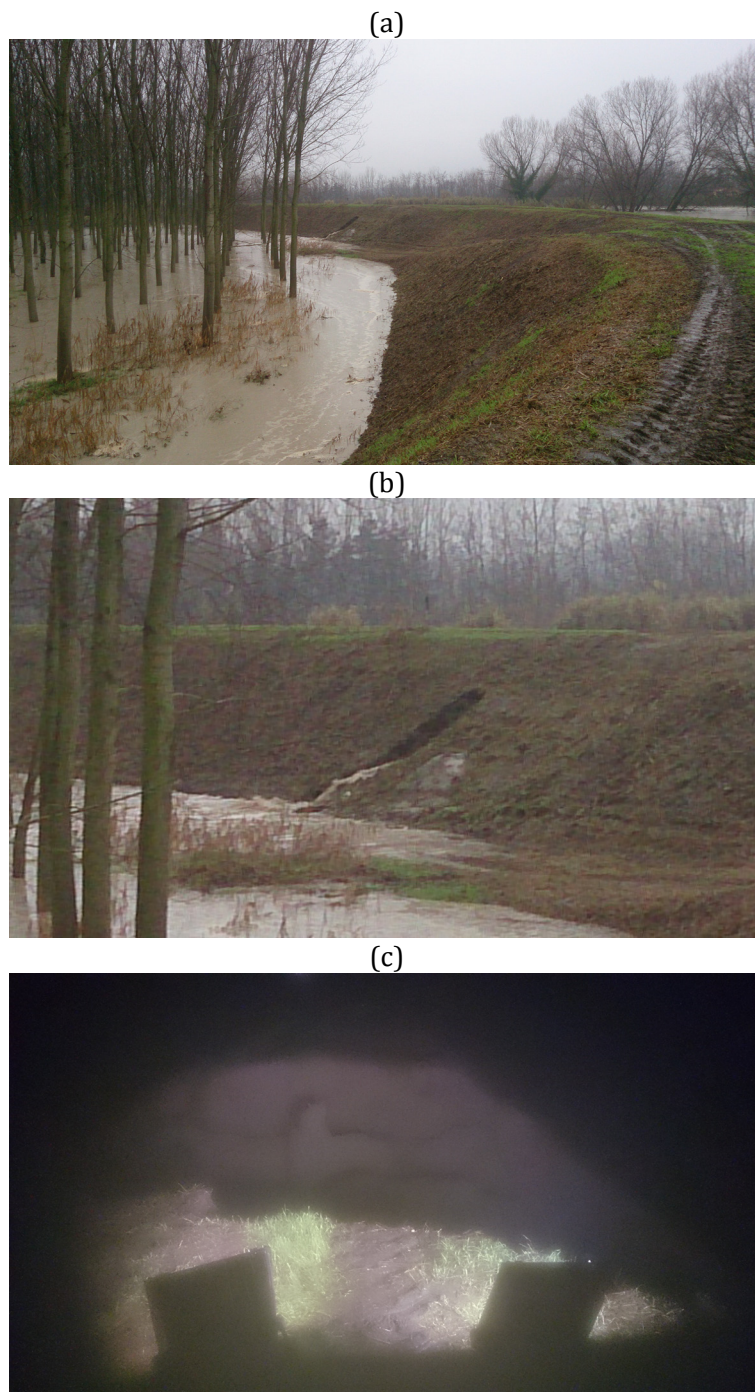
Figura 66 - Documentazione fotografica del fenomeno di erosione interna osservato il giorno 19-01-2014 nell'argine destro del fiume Panaro presso Via Tronco. (a) Tratto arginale interessato dal fenomeno. (b) Dettaglio del fenomeno di erosione interna. (c) Collasso della parte sommitale dell'argine per effetto dell'erosione interna sottostante.
