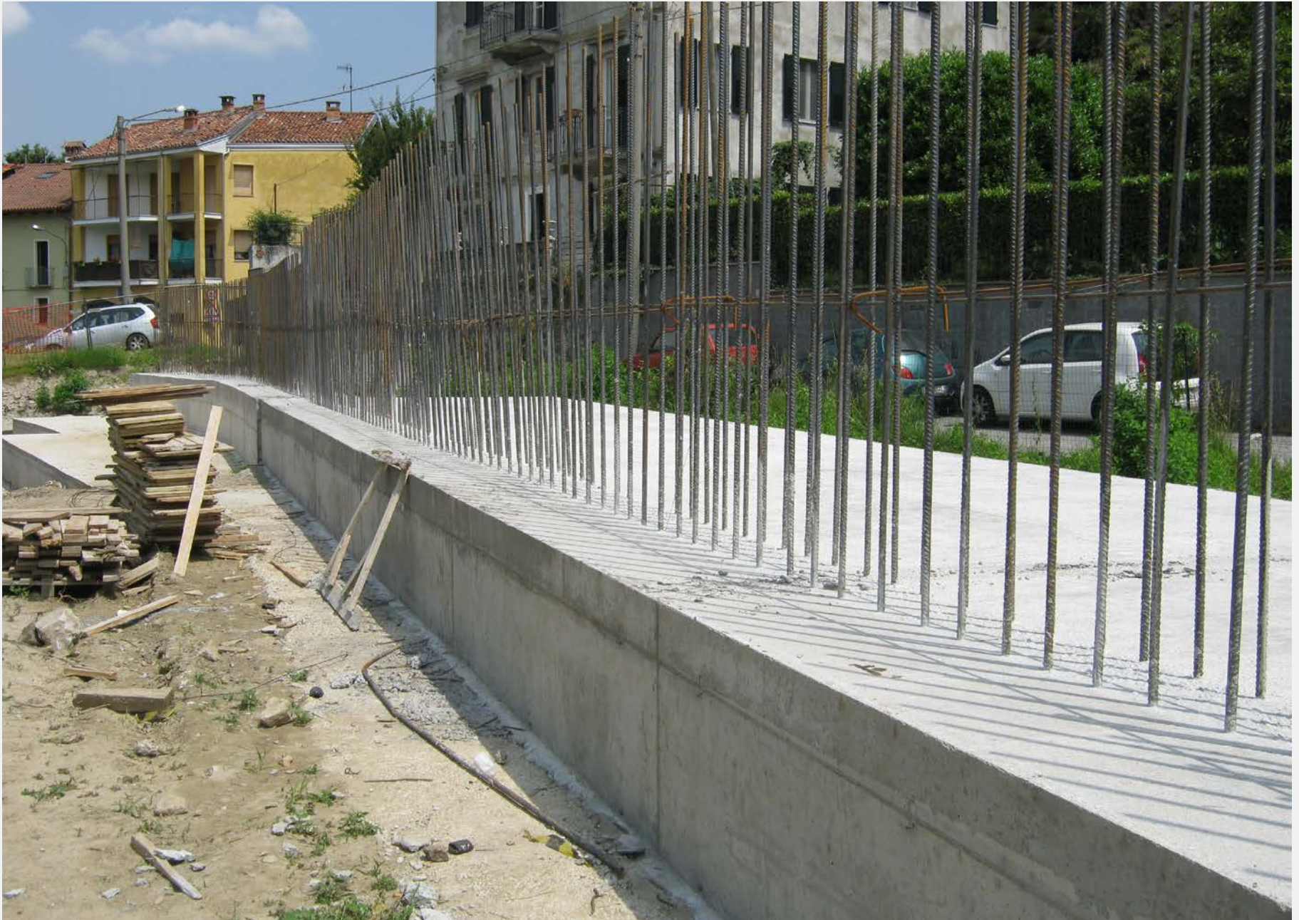
Fase di realizzazione della platea di fondazione del muro arginale nel tratto di Via delle Rocchette
