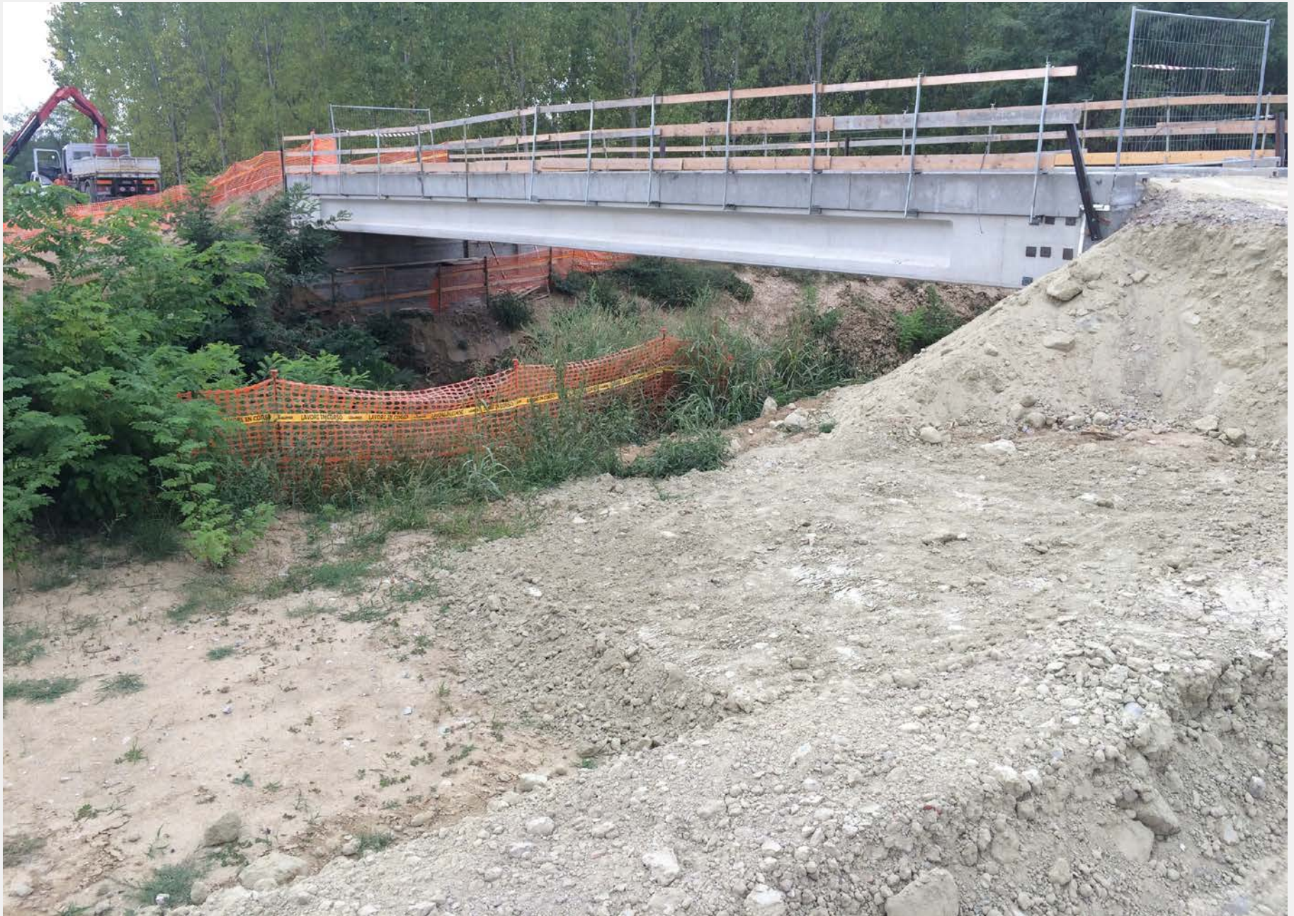
Fase di realizzazione del nuovo ponte di attraversamento del Rio Verzenasco in sostituzione del vecchio guado
