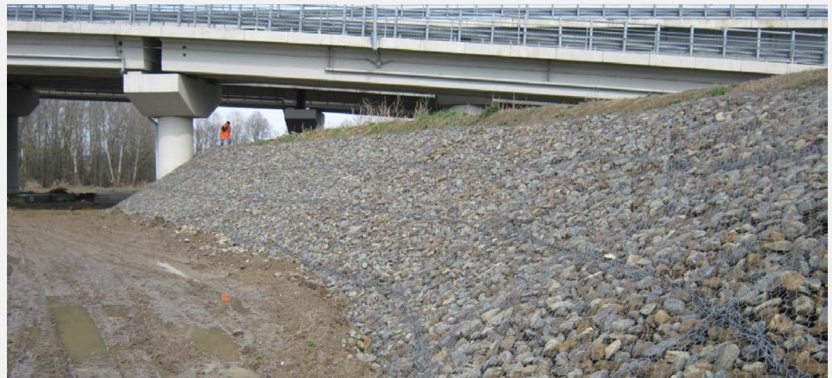
Adeguamento dell'arginatura in destra idraulica in località Orti, particolare del paramento a fiume protetto in materassi «Reno»
