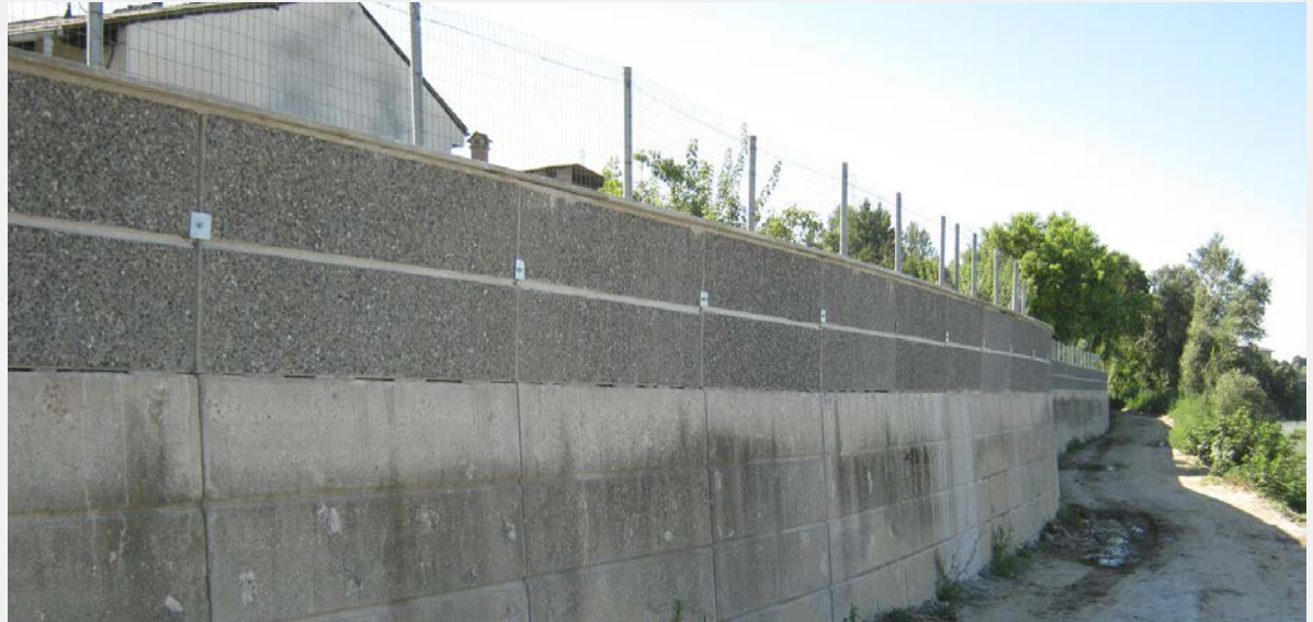
Rialzo del muro esistente in località Orti lungo le sponde del fiume Tanaro
