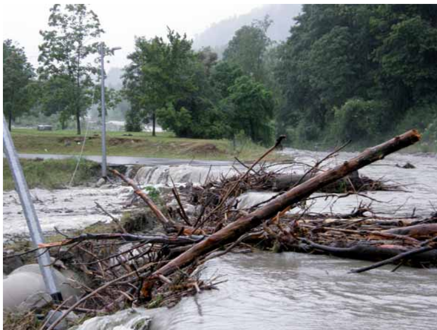
Torrente Pellice: rilevato d'accesso al Ponte della "Bertenga" (Torre Pellice) - durante la piena
