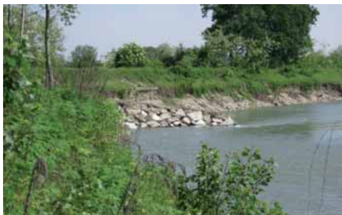
Fiume Po (Brandizzo): argine in froldo dopo la piena di maggio 2010
