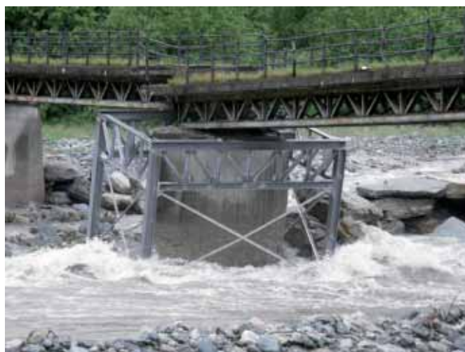
Torrente Pellice: Ponte Delle Rovine (Villar Pellice), cedimento pila
