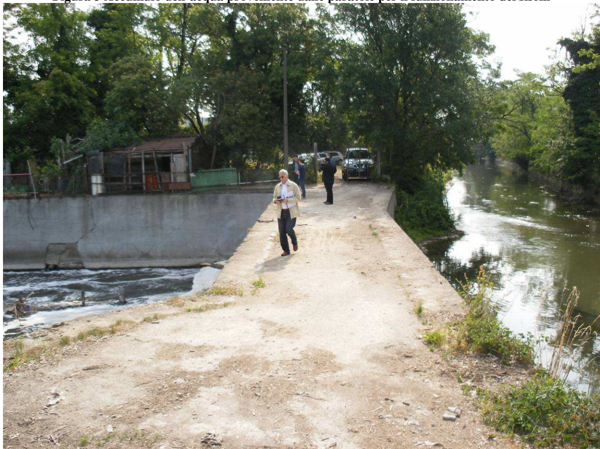
Figura 4 Impalcato sotto cui è posato il sifone. A destra il canale della Maresana e a sinistra il Lambro.
