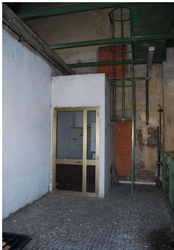
Locale quadri elettrici e di comando
