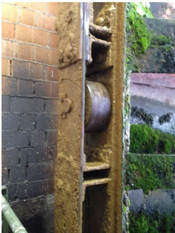
Usura dei profili costituenti la paratoia principale
