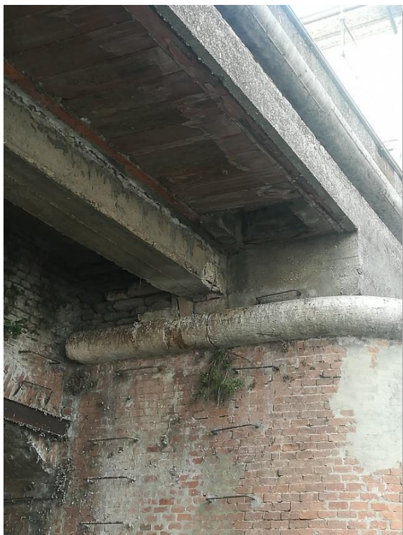
Solaio di supporto tubazione TEA S.p.a.
