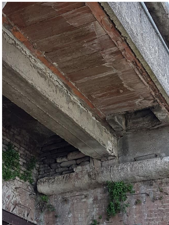
Solaio di supporto tubazione TEA S.p.a.
