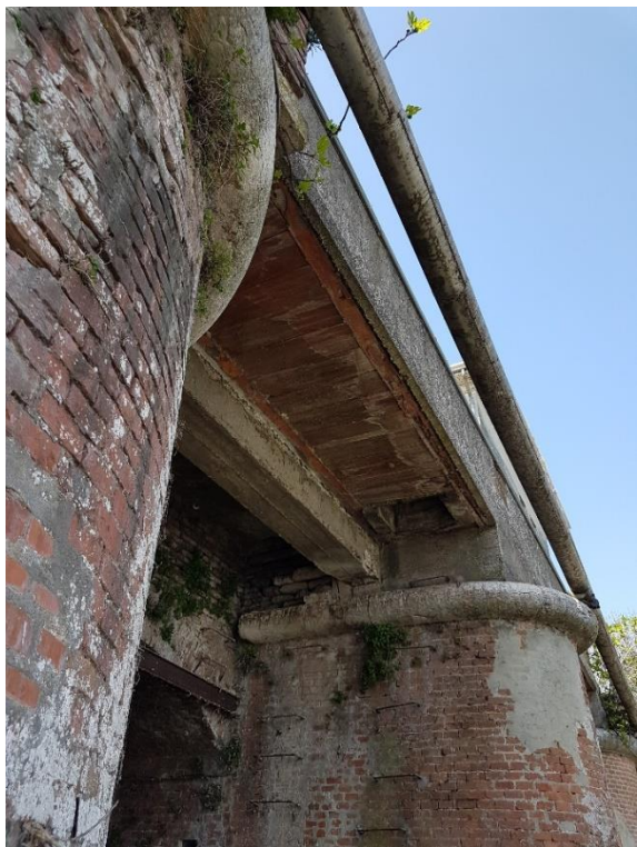
Solaio di supporto tubazione TEA S.p.a.
