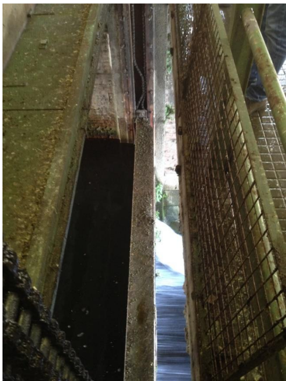
Gargamature della paratoia principale
