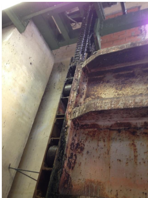
Ruote di scorrimento della paratoia principale
