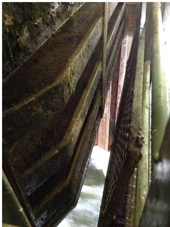
Struttura della paratoia principale
